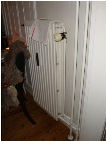
Varmeanlægget er opbygget som et 2-strengt anlæg.
