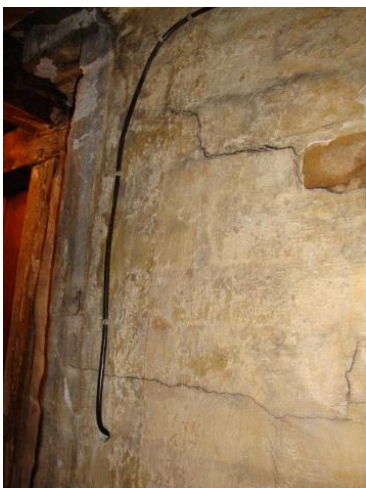
Fra loft ses en ledning ført fra loft og ind i skorsten.
