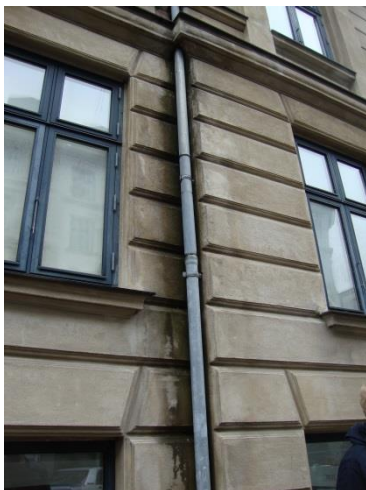
Utæt tagnedløb mod Nansensgade har opfugtet murværket.
