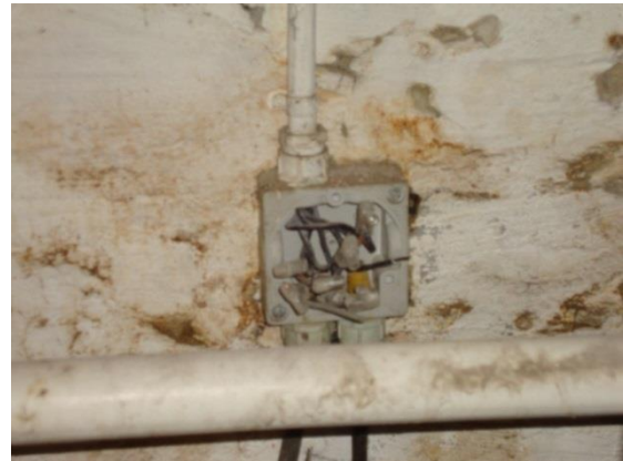
Blotlagt el-installation. Dette ses flere steder i ejendommen.
