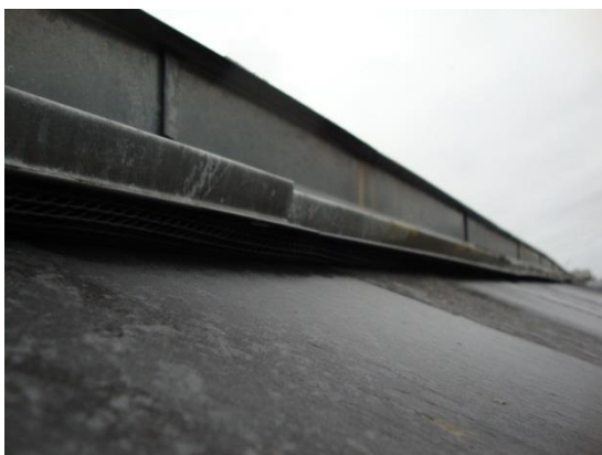
Overgangen mellem skrå- og fladt tag er udført med fugebånd. Dette fugebånd var flere steder røget ud og bør eftergås.
