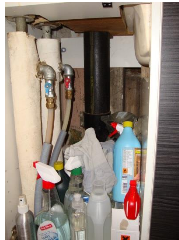
Vandinstallationer i lejlighed.
