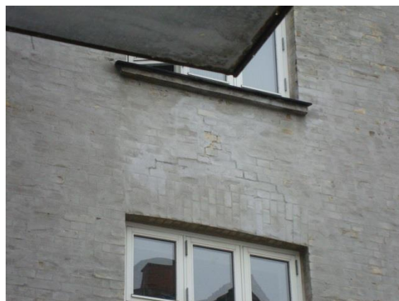
Sætningsrevner ved vinduesbrystninger er tidligere udbedret uden ilægning af jern.
