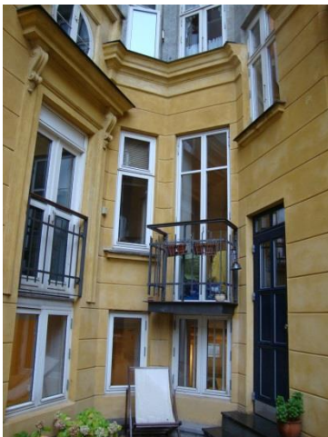
Dør til bi-trappe. Denne dør støder på altanen når den åbnes helt op, hvilket har medført et mindre hul i døren.
