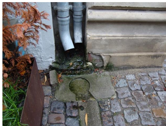
Tagnedløb med for kort udkast til tagvandsskål.
