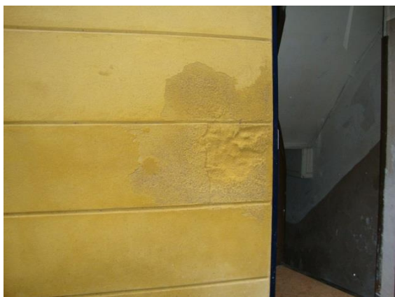
Ved bi-trappe fra Nansengade 41 th. ses afskalling på underfacade.
