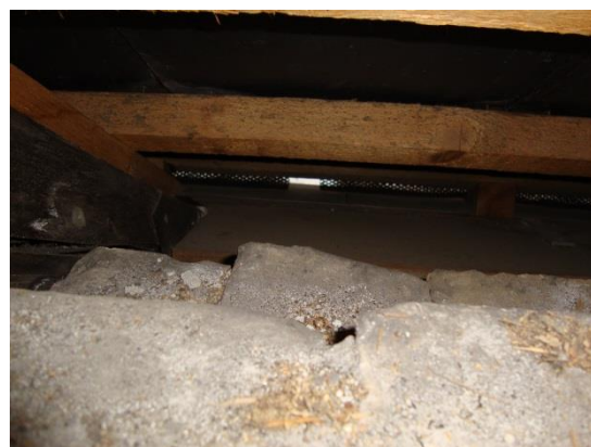
Fra tagfod ses der mindre områder med manglende snefangsrør. Dette bør eftergås.
