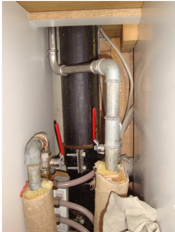
Nyere brugsvandsinstallationer og faldstamme.
