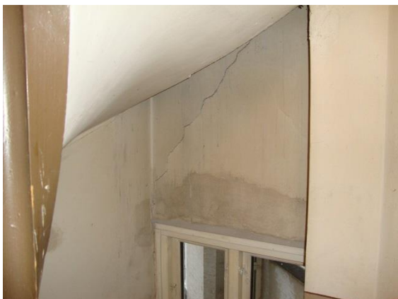
Selve bi-trapperummene fremstod med slidte overflader, og der ses revnedannelser på vægge og lofter.
