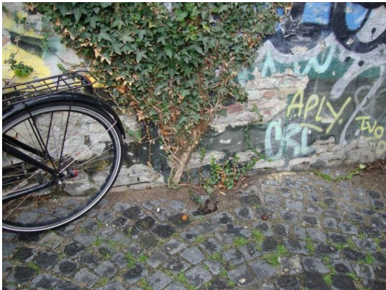
Gavl mod Charlotte Ammundsens plads. Ses lidt skader på murværk, hvilket vurderes at medføre begrænset vandindtrængning.
