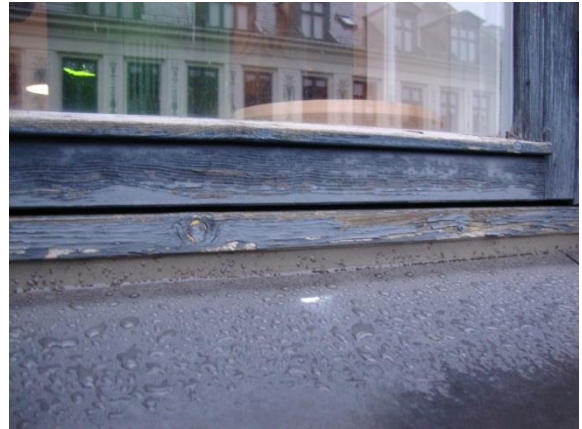
Vinduer mod gade fremstod med afskallende maling. Vindue på foto er fra 1984.
