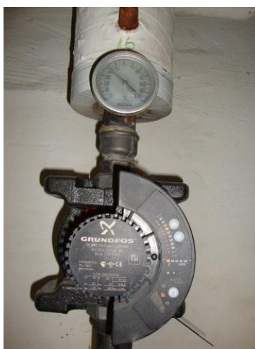
Nyere Grundfos pumpe.
