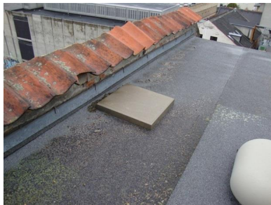
Brandkam fremstod med et enkelt flækket tegl. TDC har desuden efterladt flise på tag.
