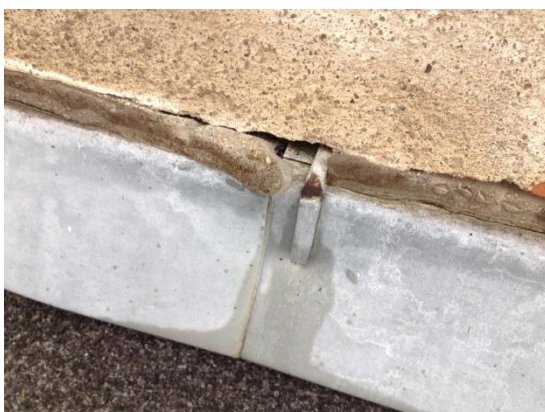
Elastisk fuge på brandkam har sluppet.
